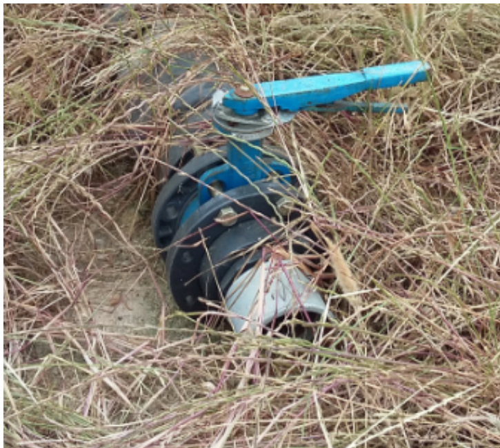
Figura 12 - Órgão de extração de efluente da lagoa
